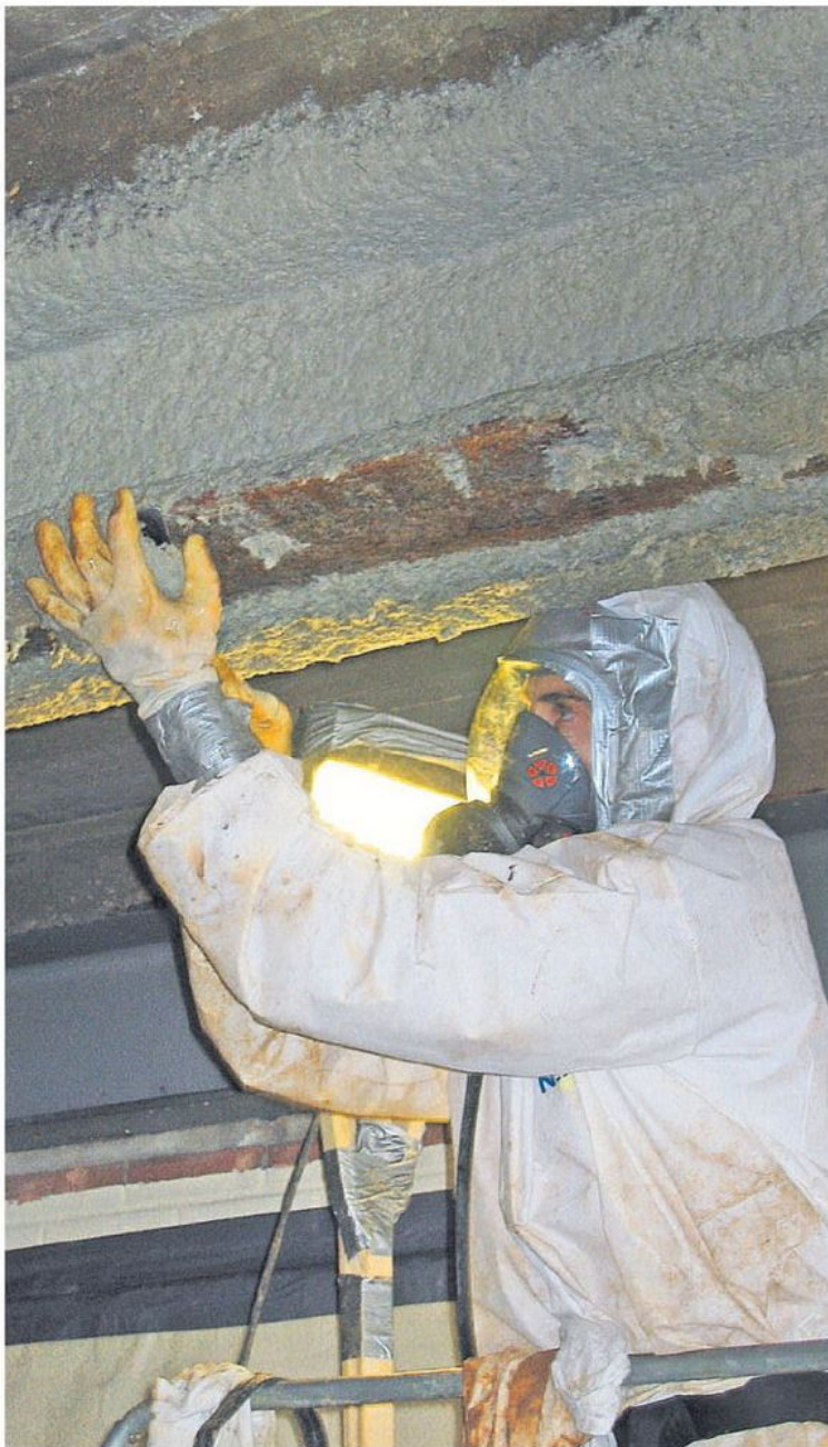
Werden bei unsachgemässer Sanierung zum Problem: asbesthaltige Baustoffe. BILD ZVG
